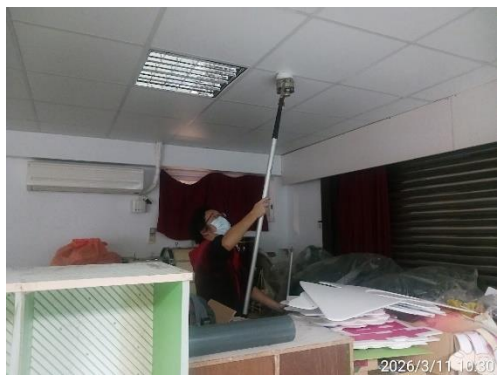
圖 11. 檢查立信樓偵測器
