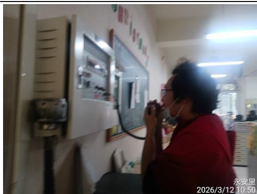
圖 19. 檢查立業樓緊急廣播機
