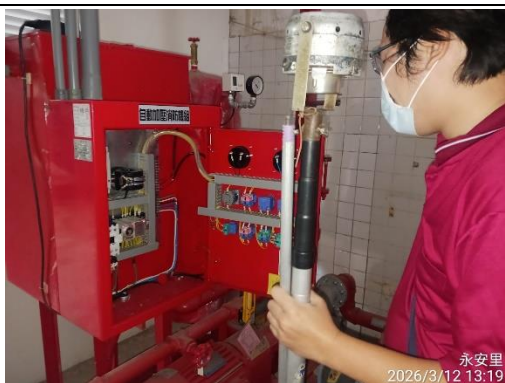
圖 23. 檢查活動中心消防泵浦
