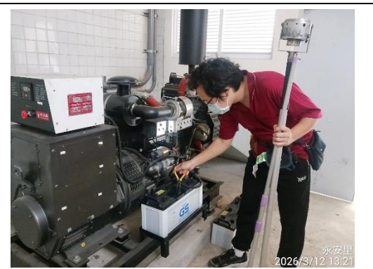
圖 24. 檢查活動中心發電機
