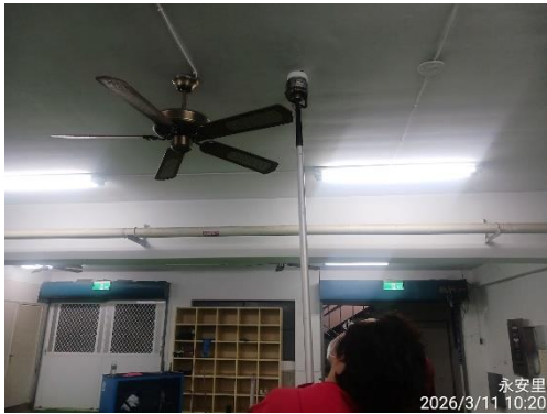
圖 9. 檢查立信樓偵測器
