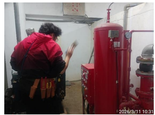
圖 12. 檢查立信樓消防泵浦
