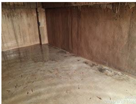
圖 69. 學生宿舍頂樓水泥水塔清洗前
