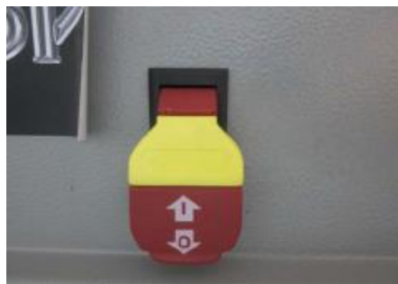
動力遮斷裝置
