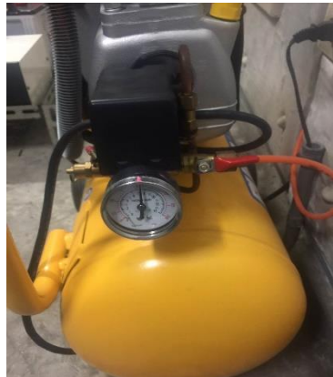
空壓機標示最高使用壓力之位置。
