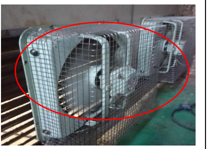
壁扇、工業用電扇未設護網或護圍
